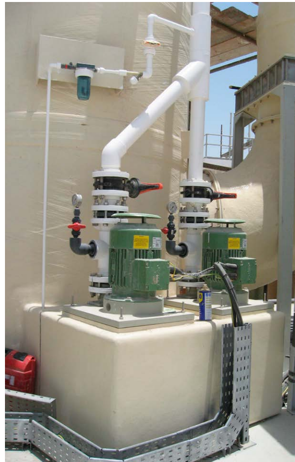
Insteekpomp op luchtwassers.
